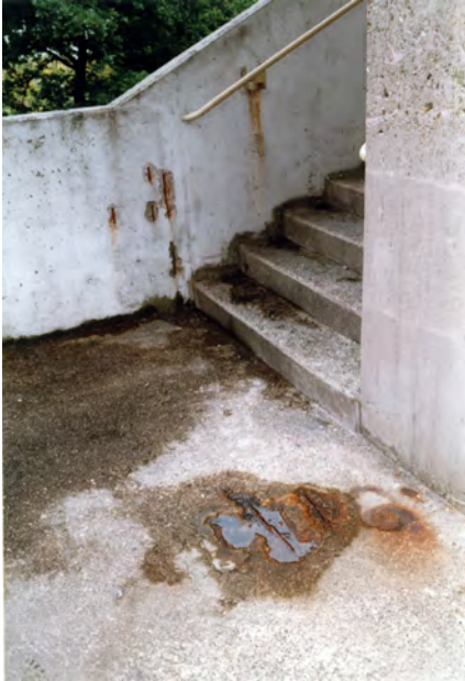
Abb. 2: Treppenaufgang am Hörsaalgebäude HNC – Betonabbrüche mit darunter freiliegender Bewehrung
