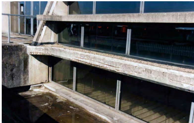
Abb. 18: Detailaufnahme der Südfassade des Mensagebäudes: bröckelnder Beton mit sichtbarem Bewehrungsstahl
