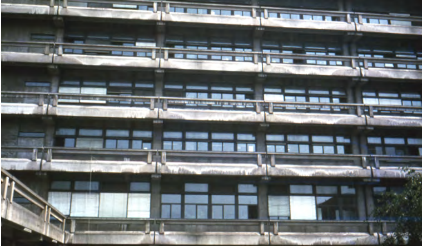
Abb. 1: Westfassade des Gebäudes NA vor der Sanierung, September 1980
