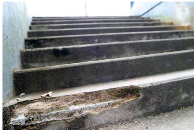
Abb. 27: Sicherheitsrelevante Schäden auch an den Außenanlagen
