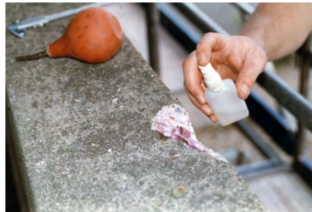
Abb. 3: Ermittlung der Karbonatisierungstiefe an einem Brüstungselement – Weiß ist die karbonatisierte Randzone über dem alkalischen, durch Indikator violett eingefärbten Kernbereich.
