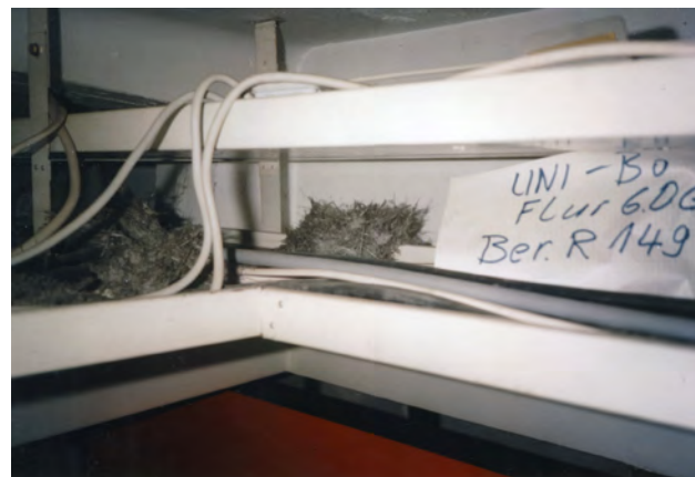
Abb. 13: Bei der Untersuchung entdeckt: lose herumliegende Asbestwolle im Bereich von Kabelkanälen
